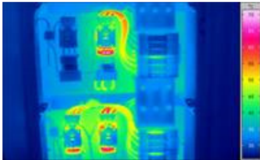
Schütze mit erhöhter Temperatur in einem Schaltschrank
